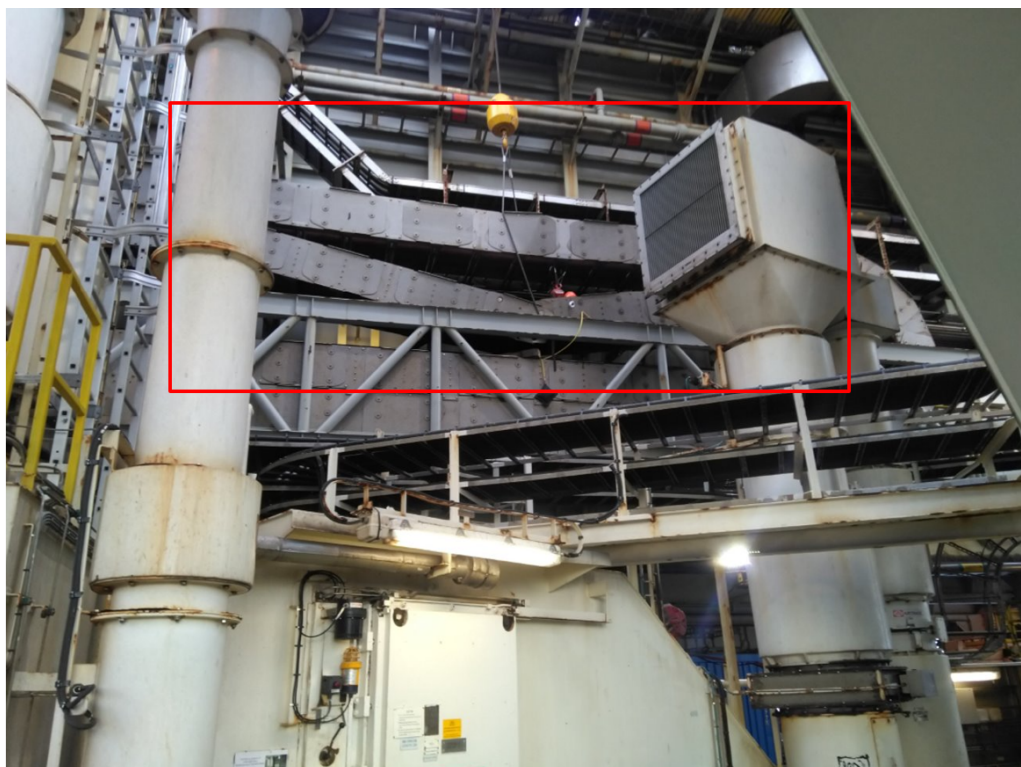
Figur 2 viser kollapset dragchain og området rundt etter at SP var frigjort. Kilde: Odfjell Technology
