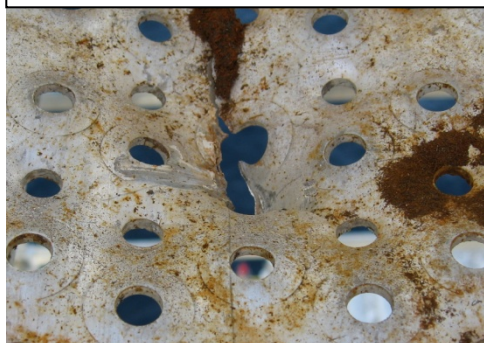
Bilde 9 viser hvordan krankrybben (hjørnet av bjelken) har slått hull i stilasgulvet.
