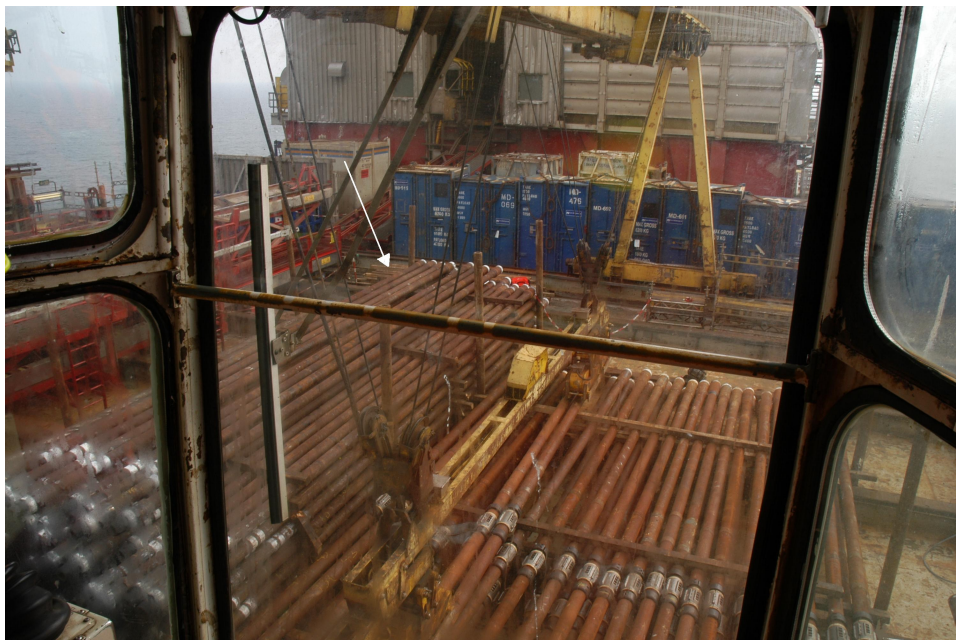
Bilde 3: Bilde fra kabin til rørhåndteringskran, i utgangsposisjon før løfteoperasjonen ble initiert. Hvit pil viser hvor skadet person befant seg.
