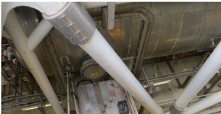
Figur 2 Innløpsseparator der mannhull er stengt. foto Ptil
