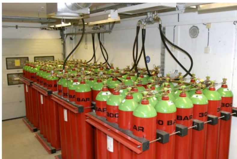
Figur 5-18: Inertgass-system (Kilde: Inergen)
