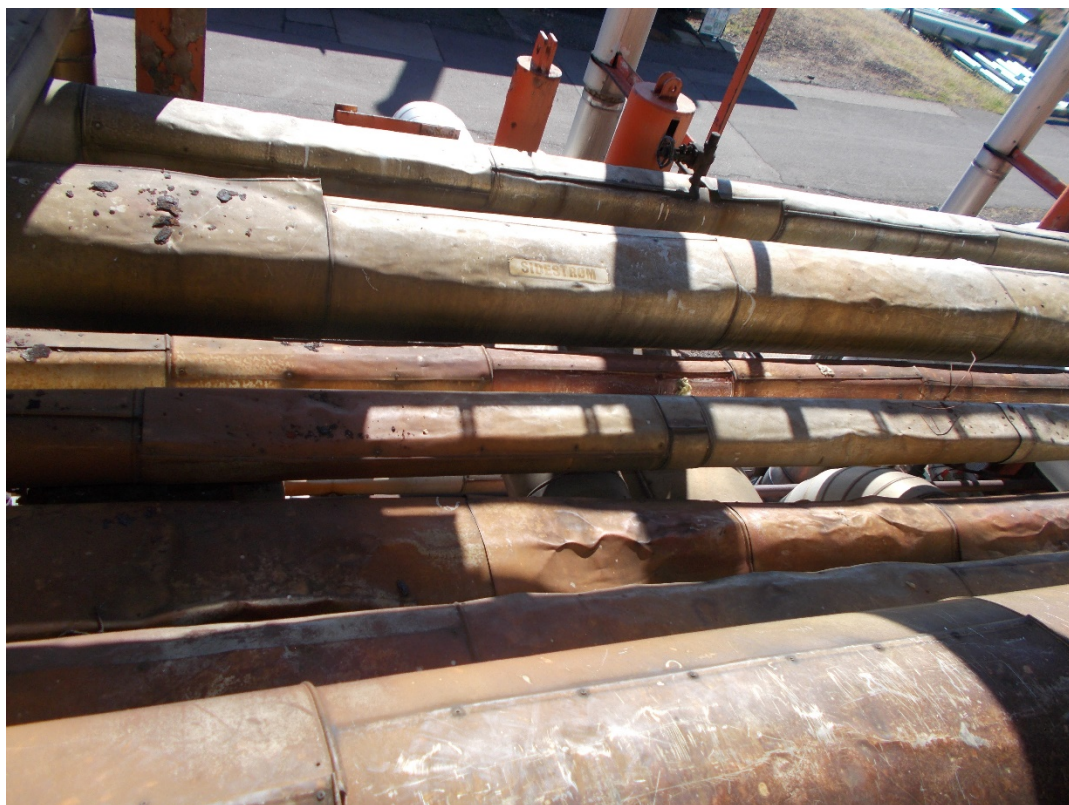
Figur 10: Tilstanden på kapslingen til isolasjon på omkringliggende rør i nærheten av lekkasjen.
