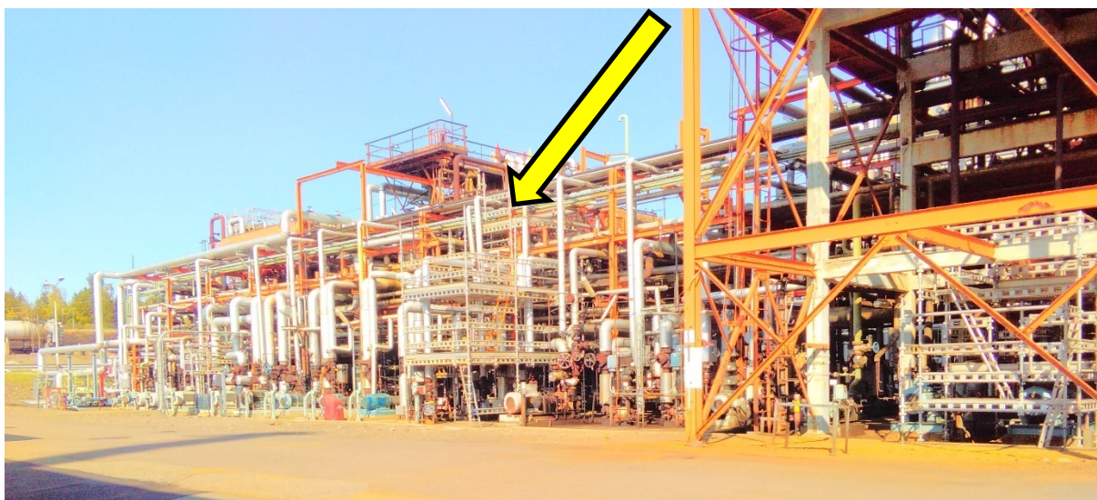
Figur 5: Pipestill, pil peker mot lekkasjested
