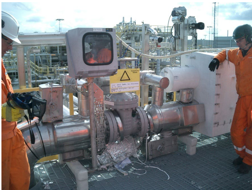
Bilde 2: Oversiktsbilde med ventil 29-4156PT. Isolasjon fjernet etter hendelsen. Lekkasje fra flens til venstre.
