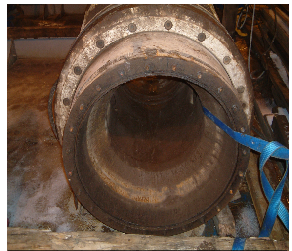
Avrevet kuleledd på stigerør.
