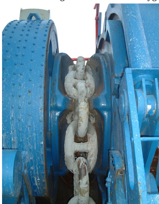
Ankervinsj m/ bandbremse, kabellarhjul og palmekanisme
