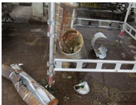
Rester av metallkappen ble kastet av røret
