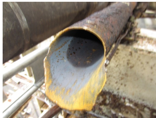
Damprøret nedstrøms bruddstedet viser kraftig korrosjon
