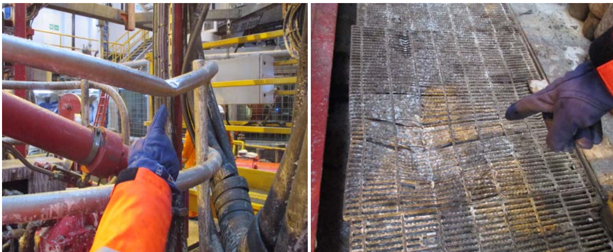
Figur 16 Skadet rekkverk og dørkrist
