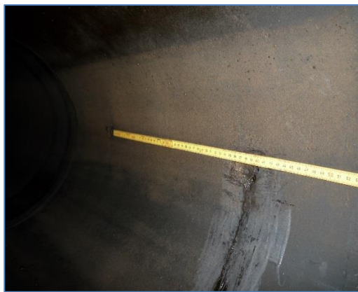
Foto 6.4 Korrosjongrop #2, ca. 70 cm fra flens A, kl. 7
