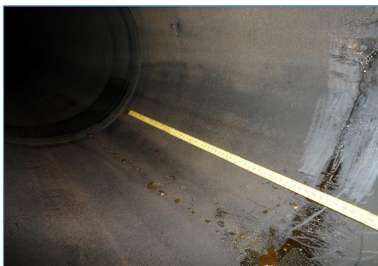
Foto 6.5 Korrosjongrop #3, ca. 85 cm fra flens A, kl. 8
