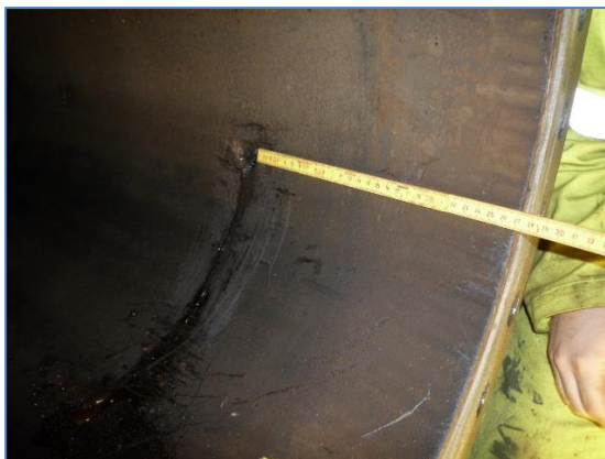
Foto 6.3 Korrosjongrop #1, ca. 30 cm fra flens A, kl. 7
