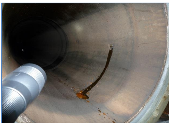
Foto 6.1 Korrosjongrop #1 ved flens A
