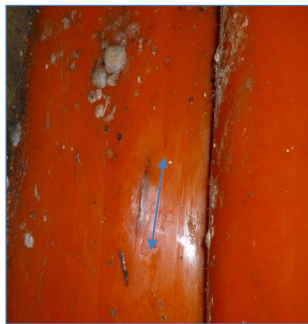
Foto 4.2 Flenge i polyuretanlag (30x0,6 mm) Pil markerer flengens lengde.
