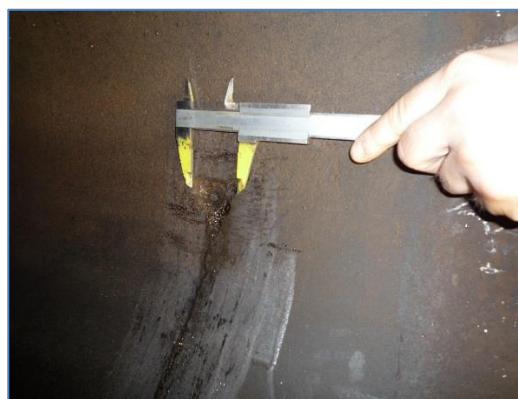
Foto 6.2 Korrosjongrop #1 ved flens A
