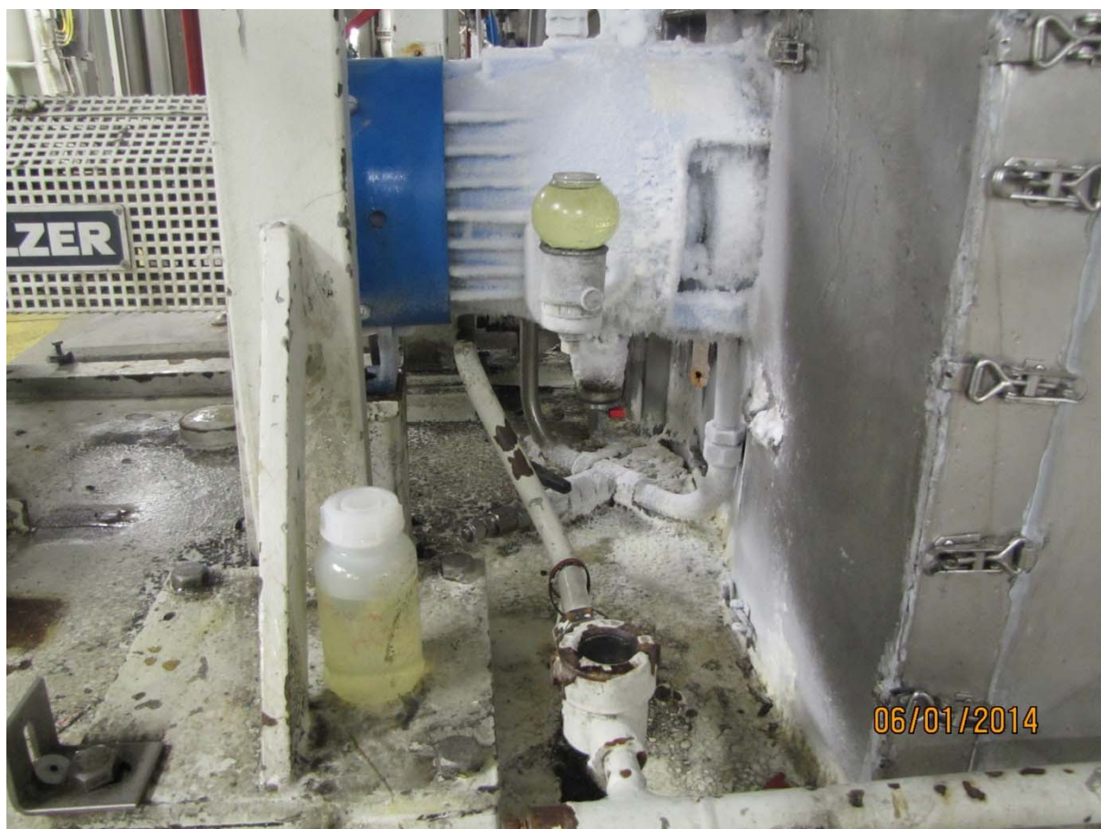
Bilde 4. Nærbilde av lekkasjestedet.
