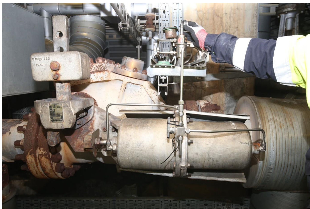
Figur 7 Bilde av Flintstoneventilen etter hendelsen (kilde: Kripos)
