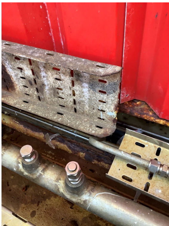
Bilde 3 Lekkasjepunkt 1, Statpipe målestasjon, Statfjord B (Kilde: Bilde tatt under vår gransking)
