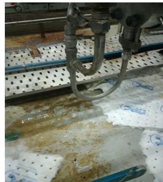
Fuktighet under rørkoblinger. Foto: Laila Årdal
