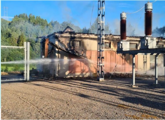
ALVOR: Transformatorstasjon i Siljan kommune brant ned til grunnen i 2022.
