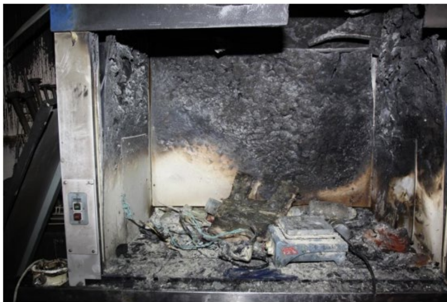
Figur 5 Avtrekkskabinett i slamlaboratoriet (fra politiet)
