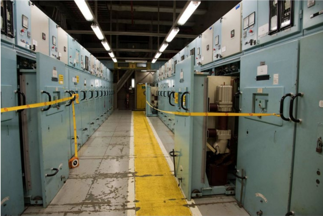
Bilde 1 - Bryterskuffer i tavlerom KC0001
