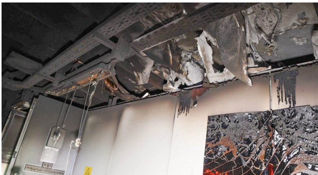
Figur 26 Termisk isolasjon i himling over VSD (3 av 3) (Kilde: Politiet)
