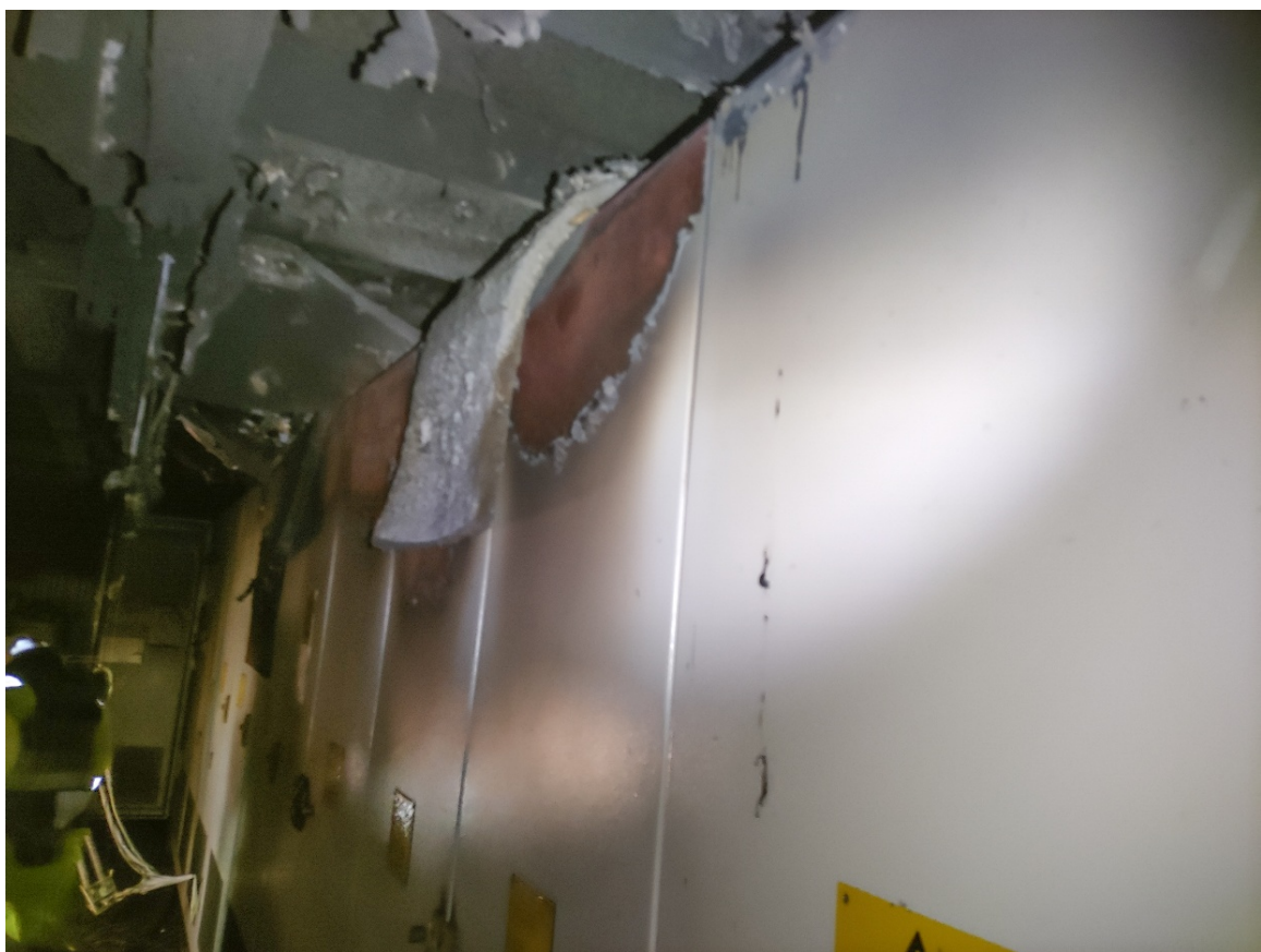
Figur 25 Termisk isolasjon i himling over VSD (2 av 3) (Kilde: Havtil)
