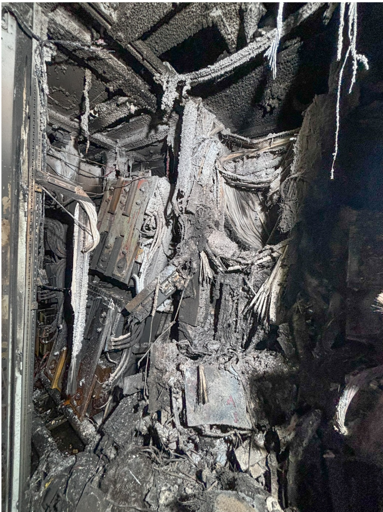
Figur 28 Brannskader VSD sett fra dør nr. 6 og mot DC-link (Kilde: Politiet)
