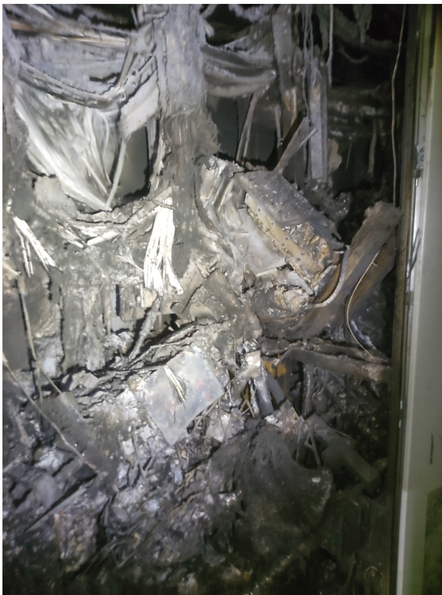
Figur 29 Brannskader VSD sett fra dør nr. 7 og mot utgangsfiler (Kilde: Politiet)
