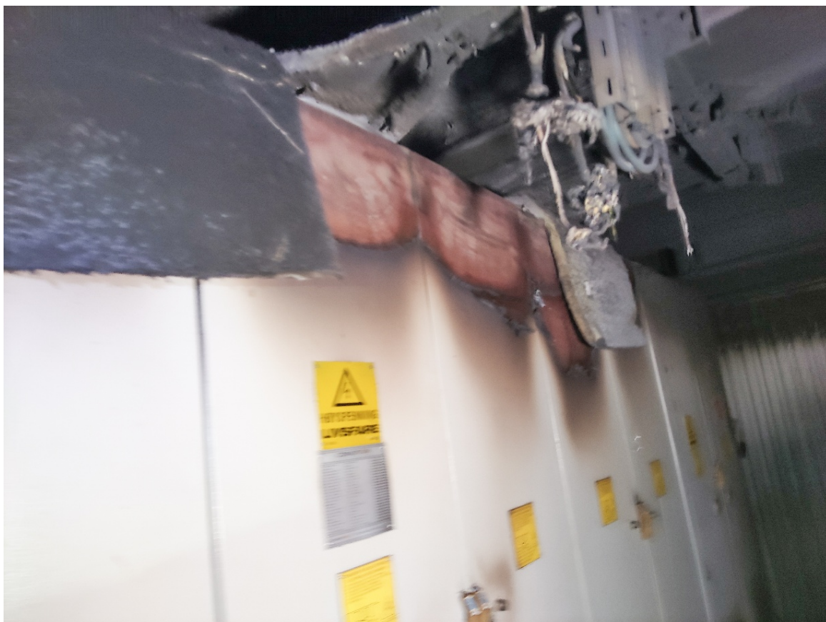
Figur 24 Termisk isolasjon i himling over VSD (1 av 3) (Kilde: Havtil)
