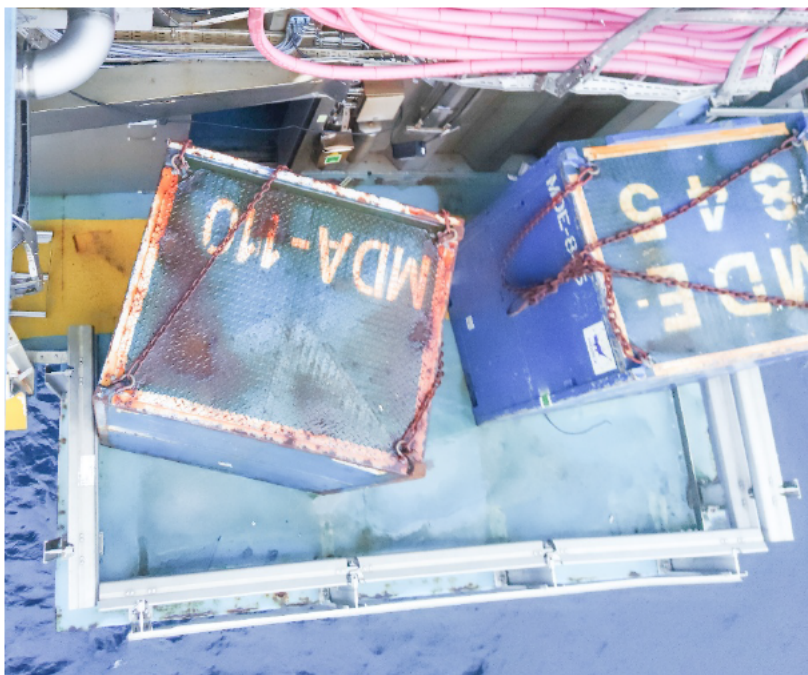
Figur 17 Pneumatisk skyvedør inn til høyspenningsrom, på bildet er de to konteinerene forskjøvet inn mot døren som følge av spyling med brannkanoner fra fartøy (Kilde: Havtil)
