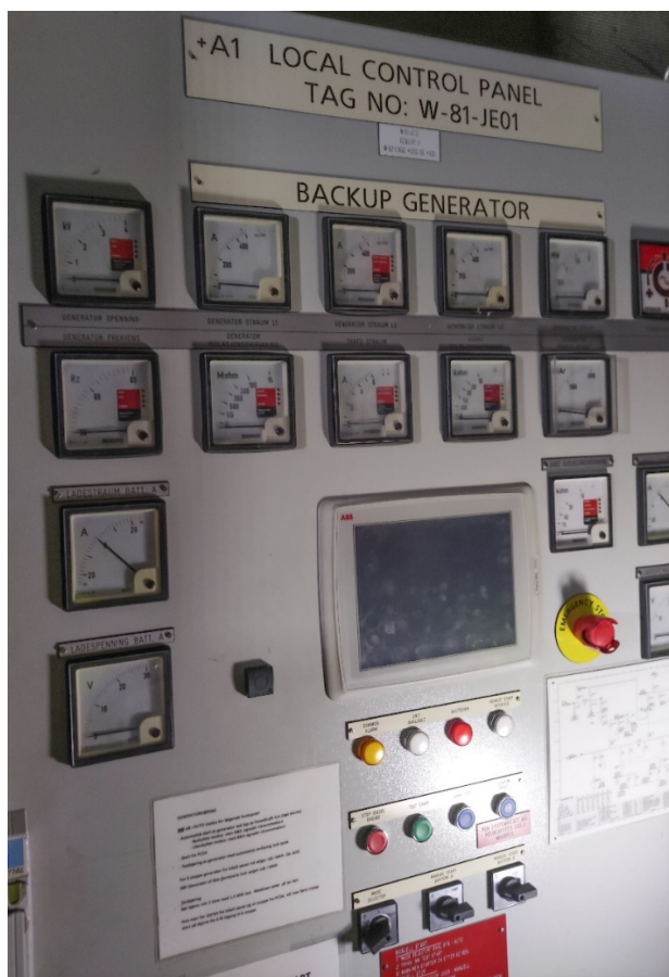
Figur 2 Lokalt kontrollpanel for reservekraftgeneratoren på SLB. Bildet ble tatt ved Havtils befaring etter brannen. 'Mode selector' i midten nederst på bilde står i Auto. Vi har forsøkt å få tilgang til eventuelle alarmer fra alarmpanelet, men har ikke lyktes med dette. (Kilde: Havtil)
