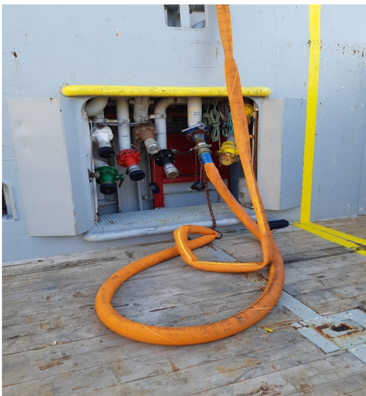
Bilde: Slangestasjon på Sjoborg
