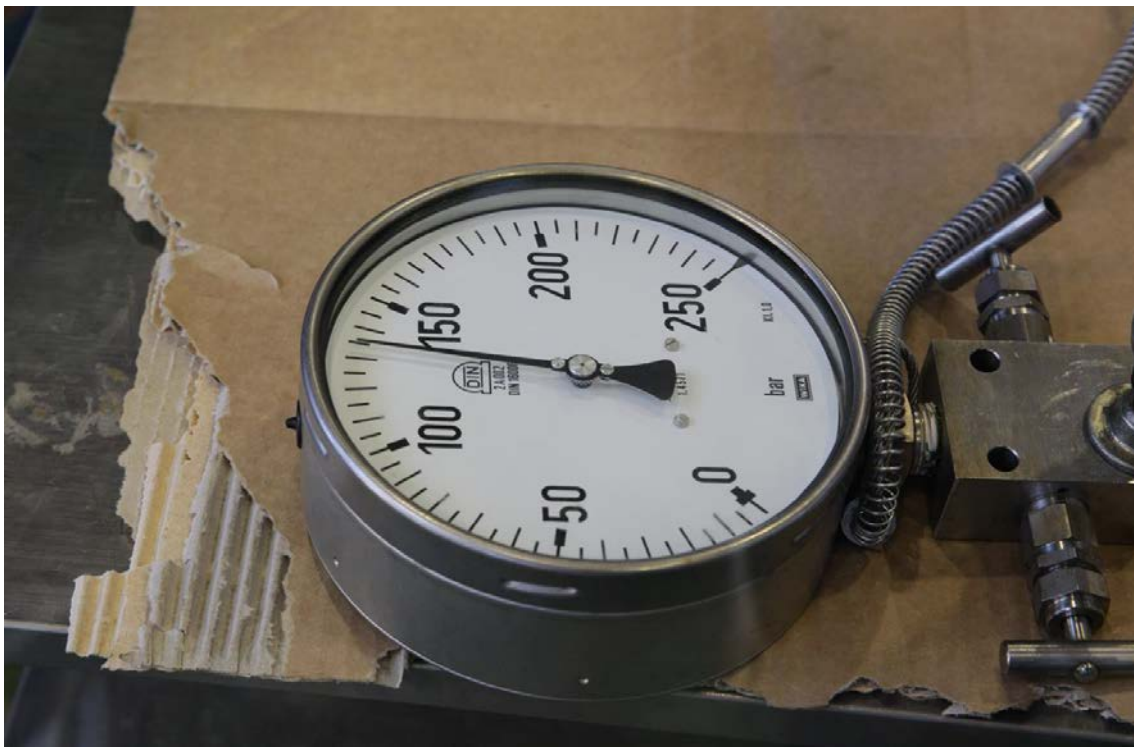
Figur 42. Manometeret viste ca. 135 bar under trykktesten.
