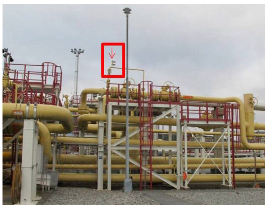
Figur 8 Bilde som viser plassering av manometer på toppen av 2" bypass linje sett fra sør
