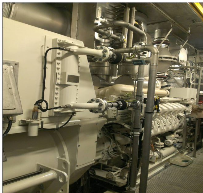
Bildet over viser rørføring, flenser og koblinger tilhørende kjølevannssystemet til dieselgeneratoren
