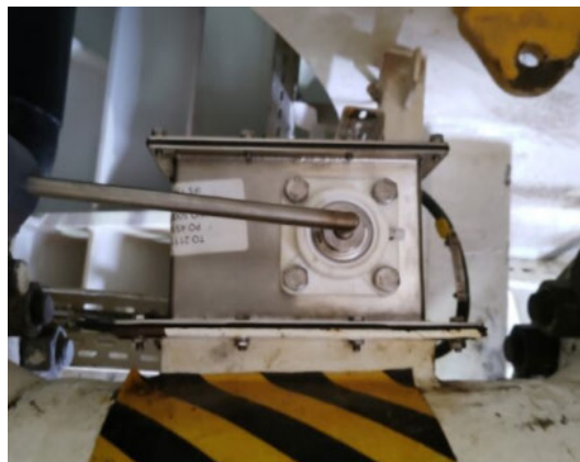
Bilde 9 Tilbakeslagsventil på returstrømningslinjen til shakere (kilde: Havtil)
