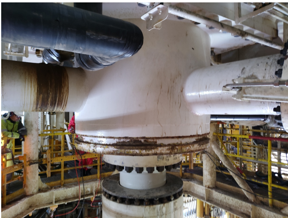
Bilde 6 Avledningssystemet på Deepsea Bollsta (kilde: Havtil)
