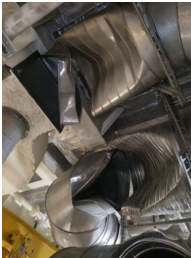
Bilde 12 Avtrekkskanaler i shakerrommet som har blitt skadet under hendelsen (kilde: Havtil)
