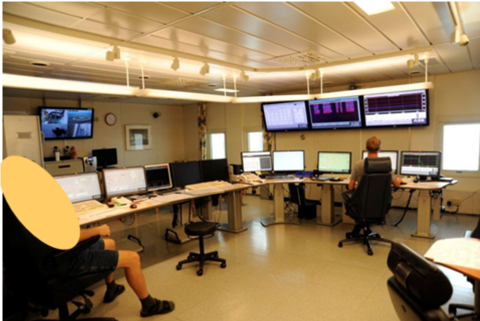
Figur 16: Viser kontrollromsoperatøren ved midlertidig arbeidsstasjon som under hendelsen . Dedikert arbeidsstasjon ute av drift vises til venstre med mørke skjermer
