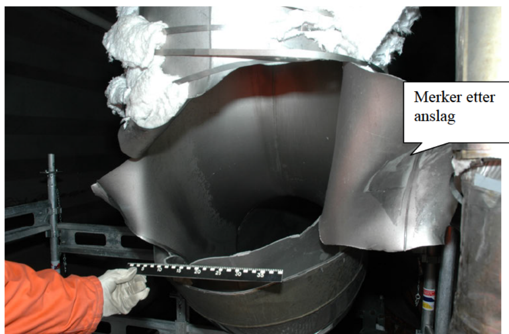
Figur 5 Hullet i fakkelerøret
