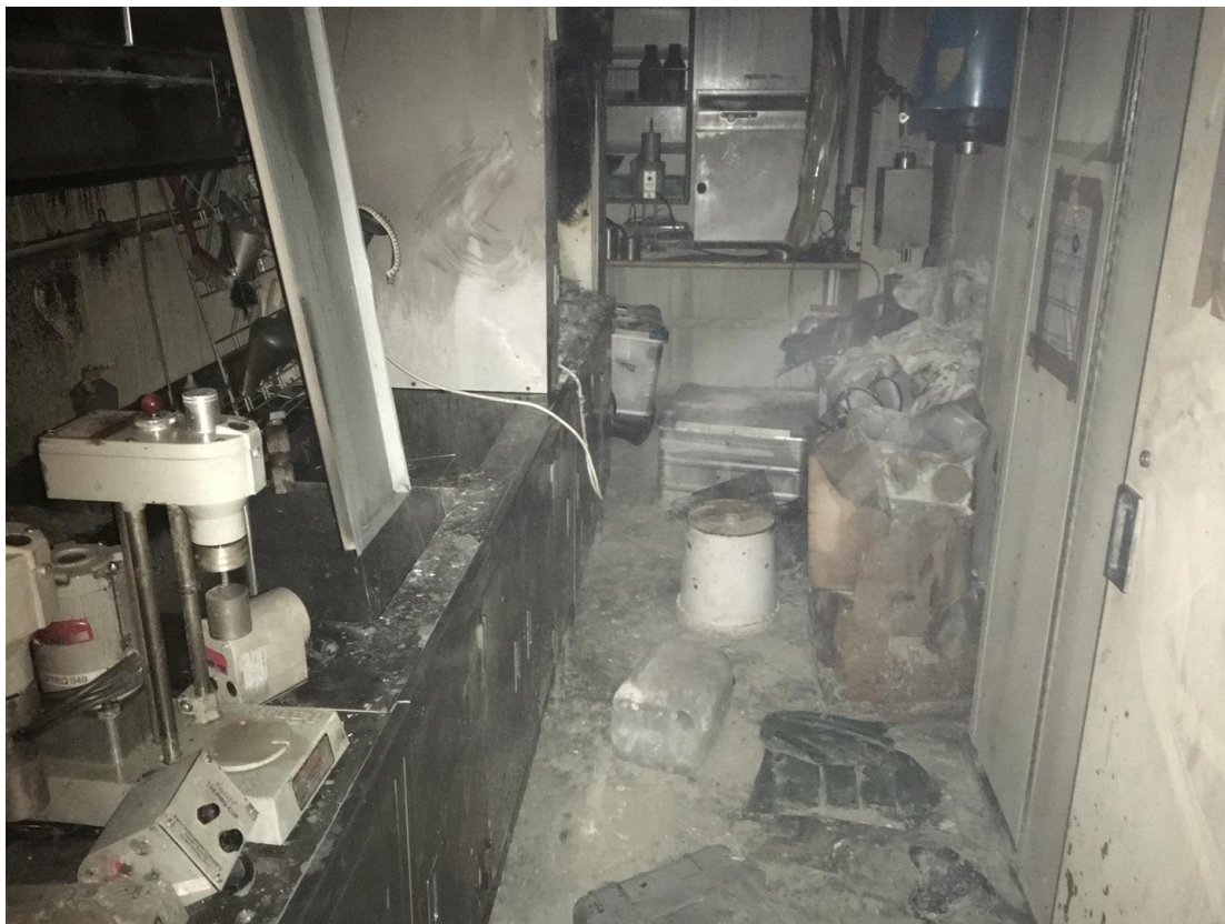
Figur 4 Oversiktsbilde i slamlaboratoriet etter brannen (fra Seadrill)
