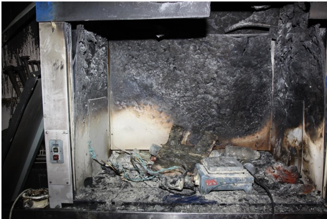
Figur 5 Avtrekkskabinett i slamlaboratoriet (fra politiet)
