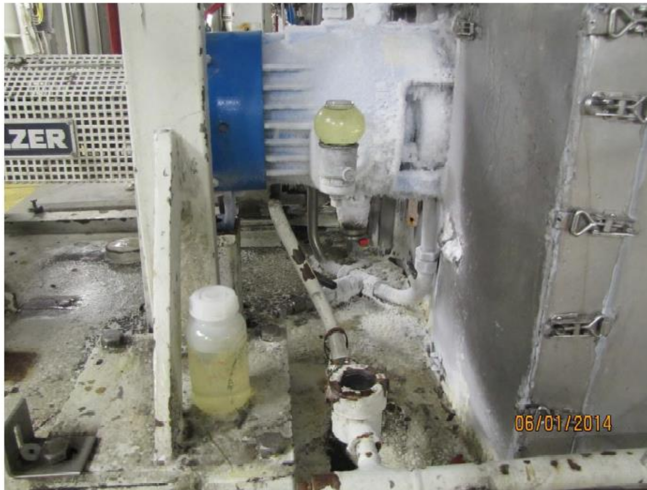
Bilde 4. Nærbilde av lekkasjestedet.
