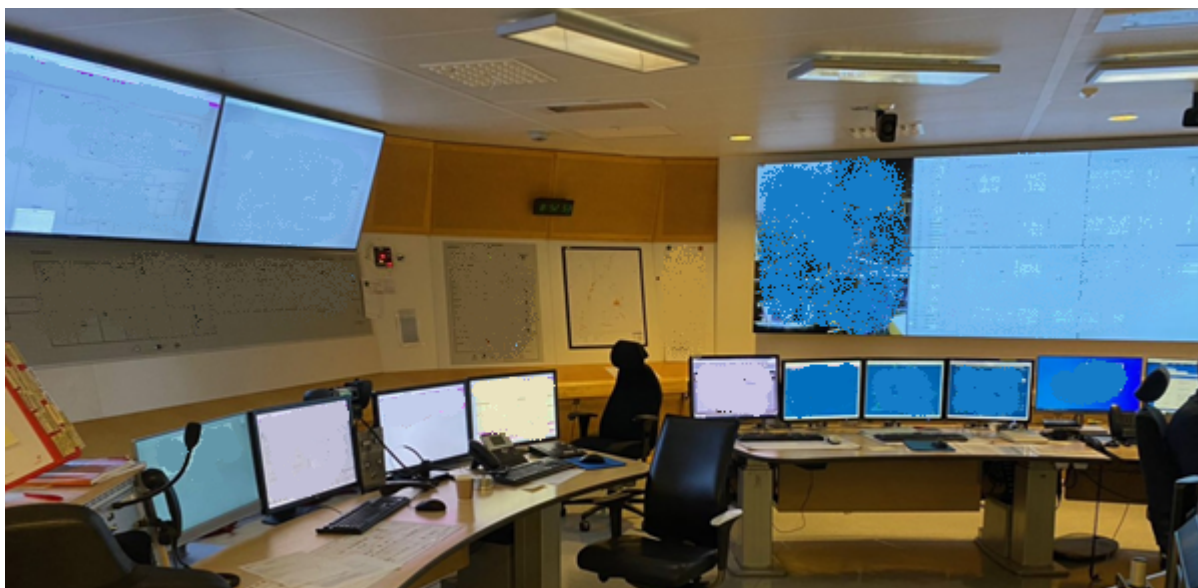
Figur 9 Bilde tatt i SKR, storskjermer, brann-, gass- og nødavstengingsoversikter og operatørsjermer, bilde tatt av Equinor
