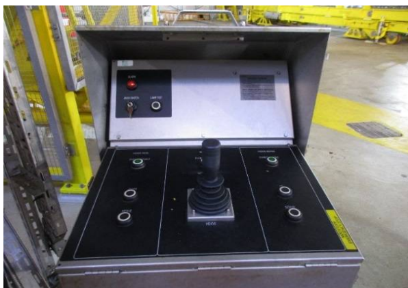
Foto 7: Kontrollpanelet for arbeidsvinsjen (Tag 33MK003) (Foto Ptil)
