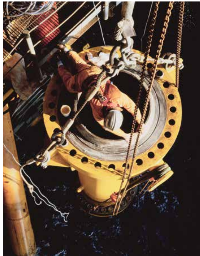
Oppjekking av innretningane på Ekofisk i 1987 er eitt av dei teknologiske c-momenta i historia om Ekofisk. Dette biletet er frå jekkinga av stigerørplattforma 2/4 R. (Foto: Industriminne Ekofisk)
