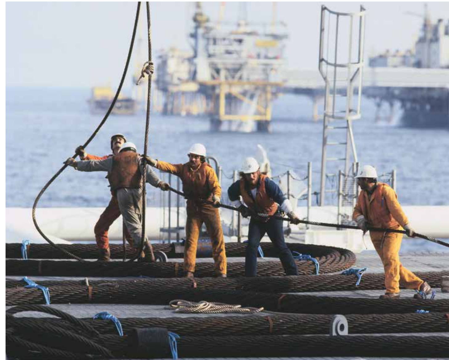
Injeksjon av vatn held trykket oppe i undergrunnen. Biletet er tatt i samband med installasjon av vassinjeksjonsinnretninga 2/4 K i 1986. (Foto: Industriminne Ekofisk)
