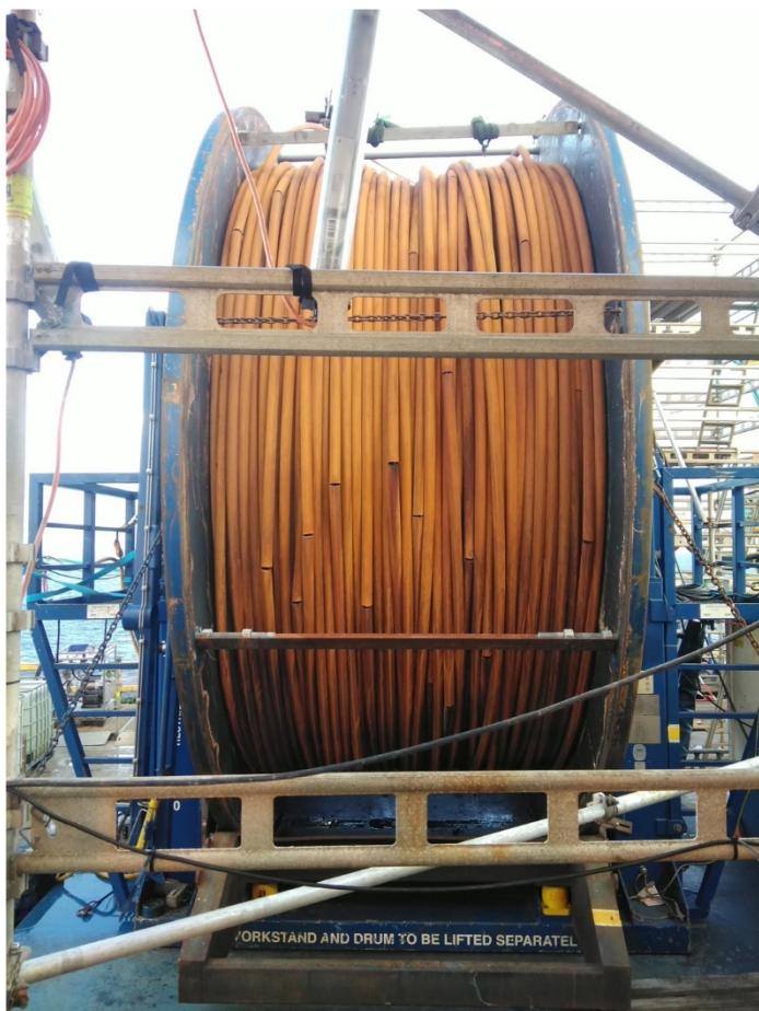
Bilde 2 - Kveilerør med brudd (Kilde: Equinor)
