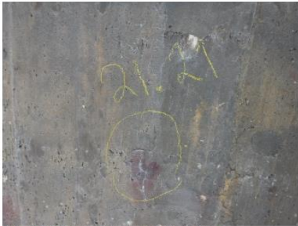
Bilde 4-17 BN 21.21, kun et svakt korrosjonsutslag i betongen uten bom
