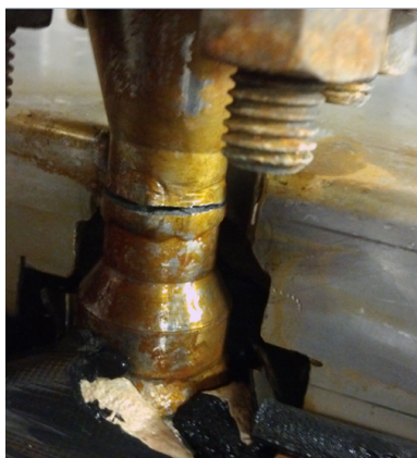
Figur 1 - Sprekk i rørstuss ut fra kondensatpumpa. Bilde tilhører Engie E&P
