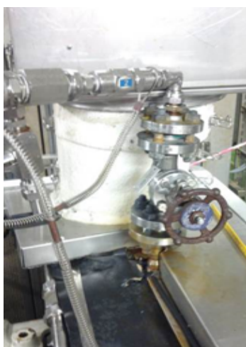
Figur 10 - Rørstuss og manuell vedlikeholdsventil påmontert på kondensatpumpe 23PA005B. Bilde tilhører Engie E&P.
