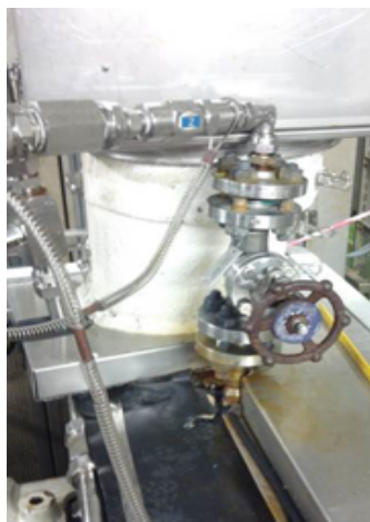
Figur 2 - Kondensatpumpe påmontert rørstuss. Bilde tilhører Engie E&P
