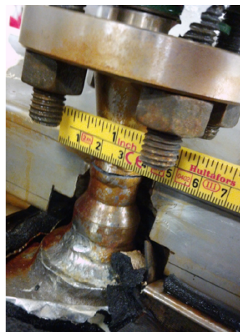
Figur 3- Sprekk i rørstuss som førte til kondensatlekkasje. Bilde tilhører Engie E&P
