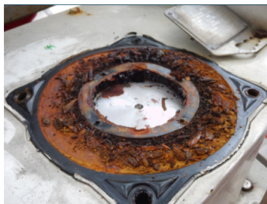
Figur 5- Åpnet aktuatorhus til ESV. Viser korrosjon på innsiden av pakning. Bilde tilhører Engie E&P
