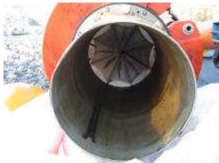
Bilde 4-5: MBC montert på delen av lasteslangen som er koblet opp mot FLP
