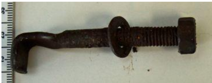
Bilde 10 Deformert festebolt (J-krok) for dekkrist, med mutter og sprengskive demontert fra luken der dekkristen løsnet
