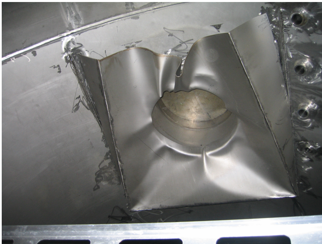
Figur 6 Hullet i deflektorplaten
