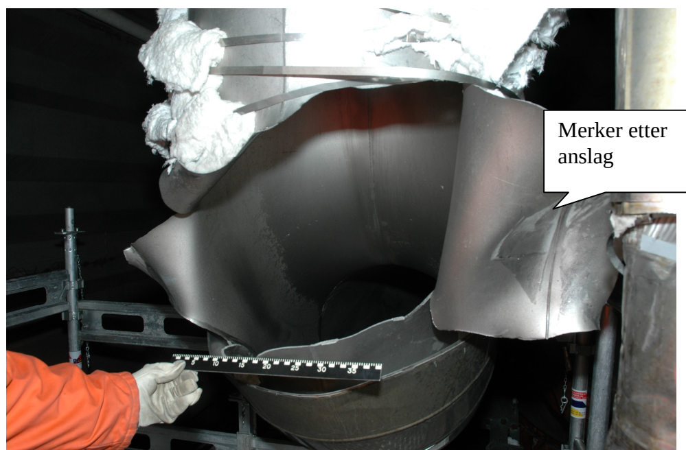
Figur 5 Hullet i fakkelerøret
