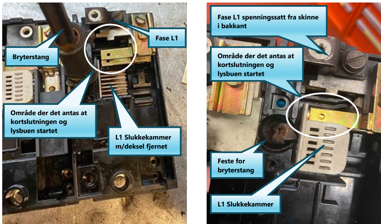
Figur 21 Bilder med informasjon fra demonteringen av reservebryteren
