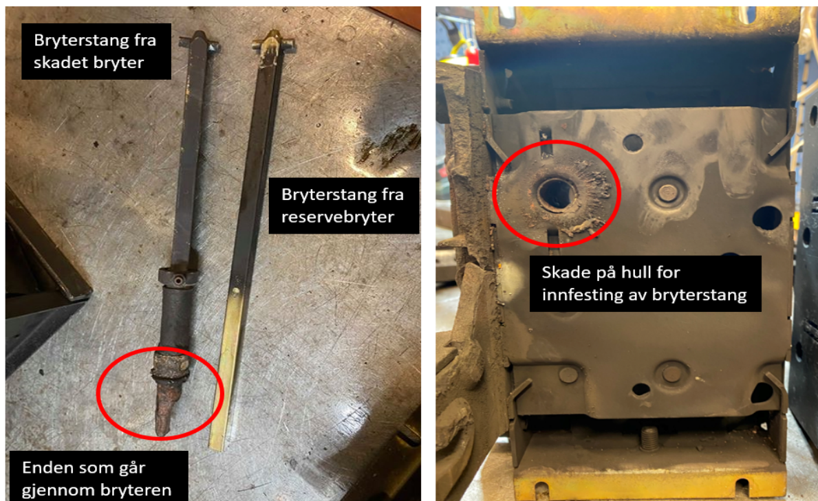
Figur 22 Bryterstenger og bilde av baksiden på skadet bryter
