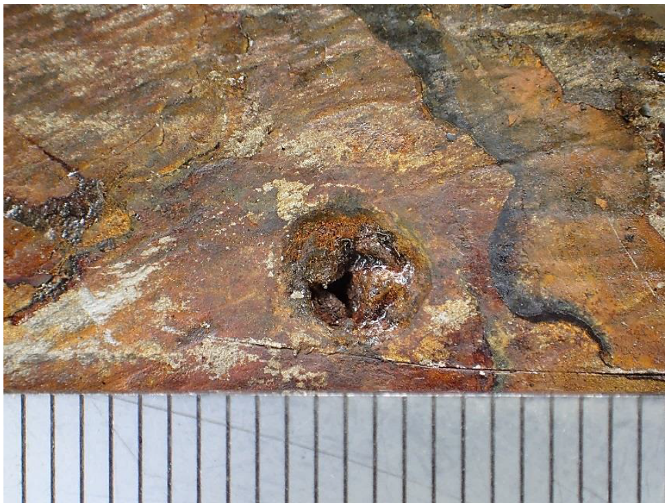
Figur 9: Nærbilde av lekkasjested sett fra utsiden av røret. Lite tegn til utvendig korrosjon av røret, men misfarging og rustavrenning observeres i området rundt lekkasjen. Målestokk er i mm.
