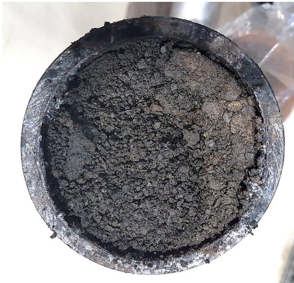
Figur 8: Vertikal del av røret fylt med porøse/løse avsetninger. I denne delen av røret var det ikke tegn til vegg-tynning av betydning. (Statoil, 2018)
