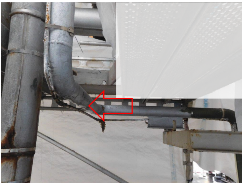
Figur 3: Lekkasjepunkt markert med rød pil. Røret ble avisolert i etter hendelsen. Kilde: Statoil.
