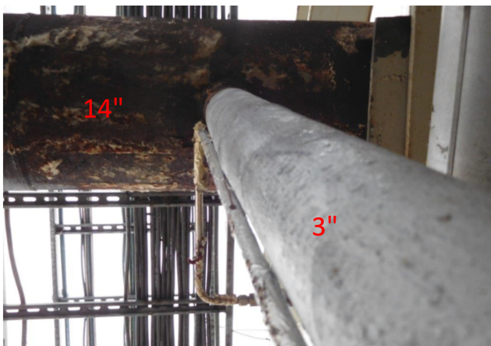
Figur 4: Overgang mellom hovedrør, 14", og pumpesikring, 3". Røret er avisolert i etter hendelsen. Kilde: Statoil.
