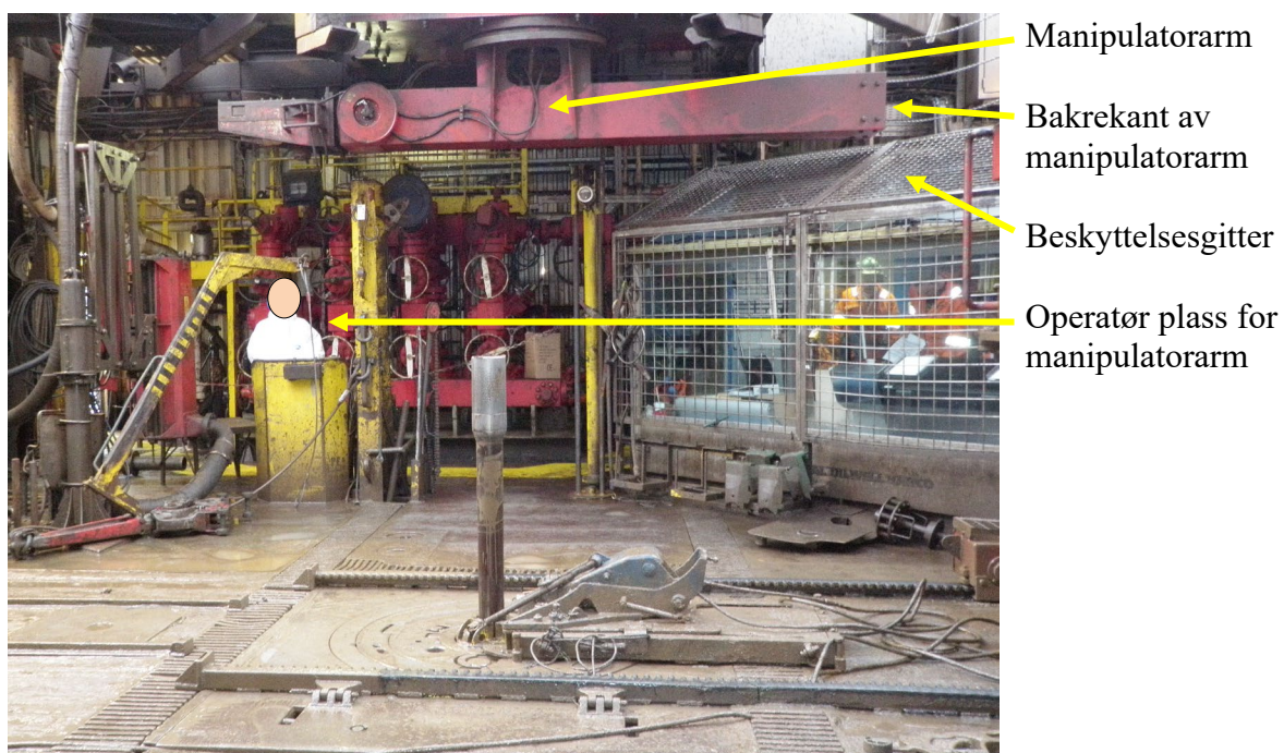
Figur 1 boredekk og LRA (manipulatorarm)
