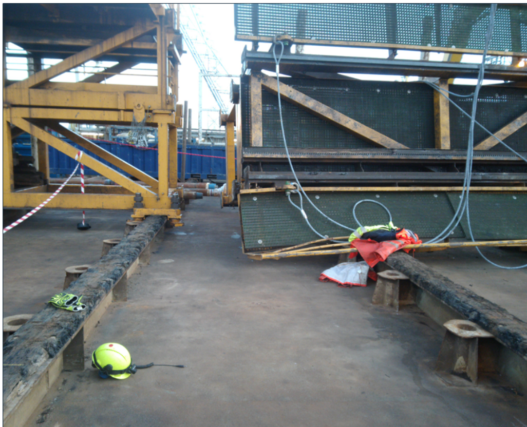
Figur 6 - Bildet hentet fra Equinor sin presentasjon av hendelsen som viser strukturen forskjøvet i lengderetningen bort fra den permanente rørbroen, samt noe vridd ift. i lengderetningen
