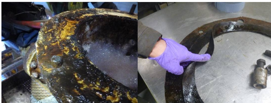
Figur 5. FS8 Manglende og defekte bolter og dobbelt sett med pakninger i lokk, samt med spennskiver mellom pakningene.
