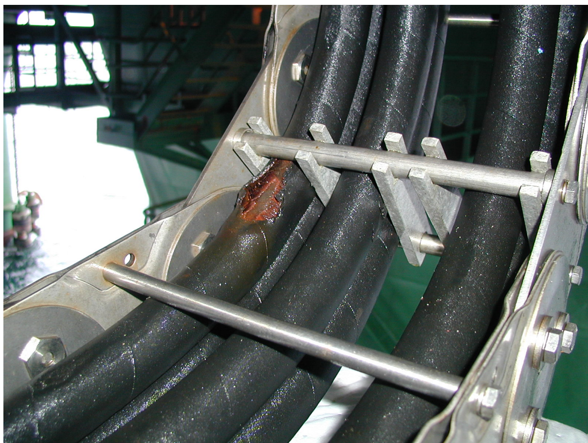
Figur 2: Bilde av skader på hydraulikkslange.
