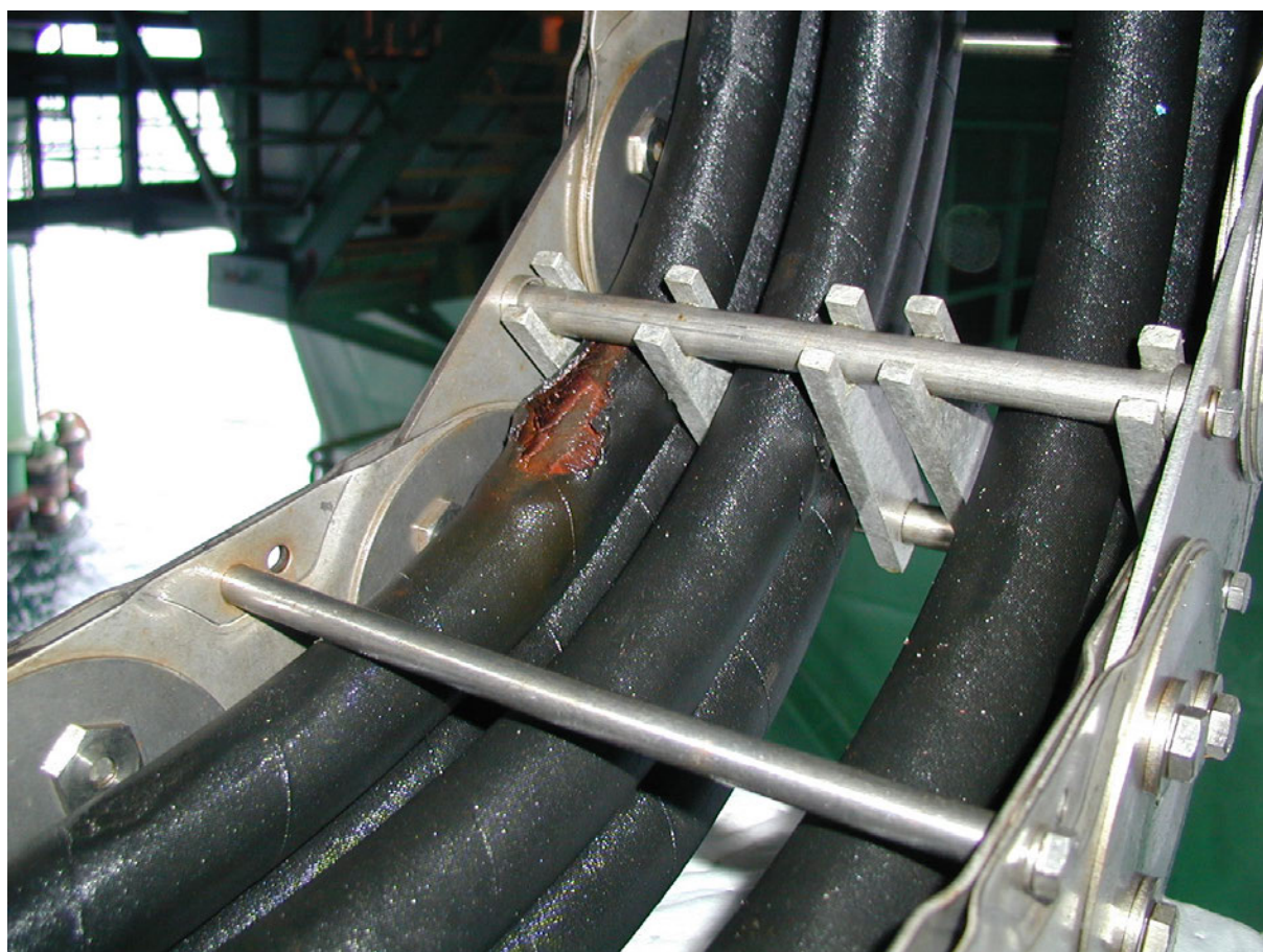
Figur 2: Bilde av skader på hydraulikkslange.
