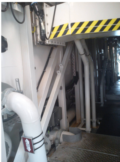
Figur 1 Hindringer i evakueringsvei fra MDR (Foto: Petroleumstilsynet)
