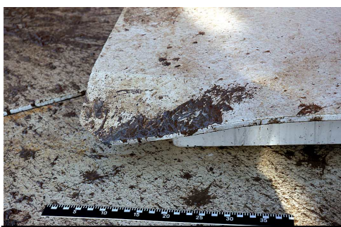
Bilde 7: Viser skaden på brønnluka.
