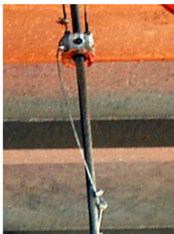
Bilde 10 viser den avrevne utløserwiren og armen som var festet til grensebryteren.
