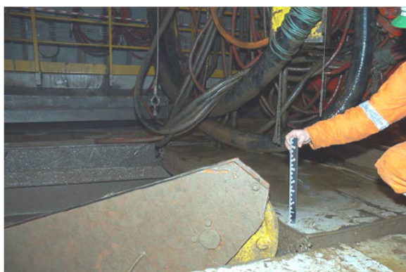
Bilde 5: Viser hvordan krantuppen stikker opp gjennom "dropped object"-dekket på WE..
