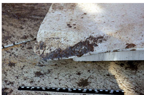
Bilde 7: Viser skaden på brønnluka.
