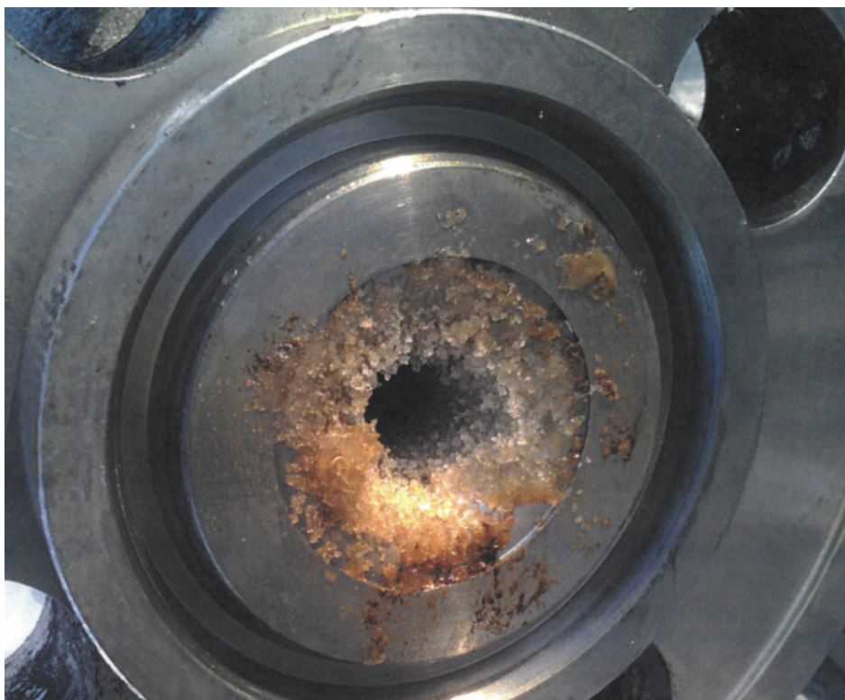
Figur 5: Eksempel 1: Hydrat/is i innløp på PSV, kilde: HLNG
