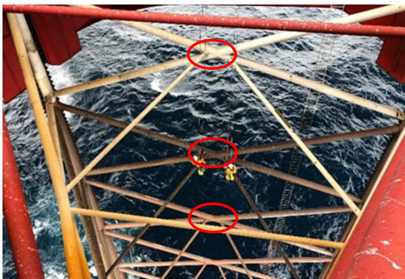
Figur 5-28 Koblinger mellom horisontalstag og krysstag hvor utmattingssprekker har blitt observert
