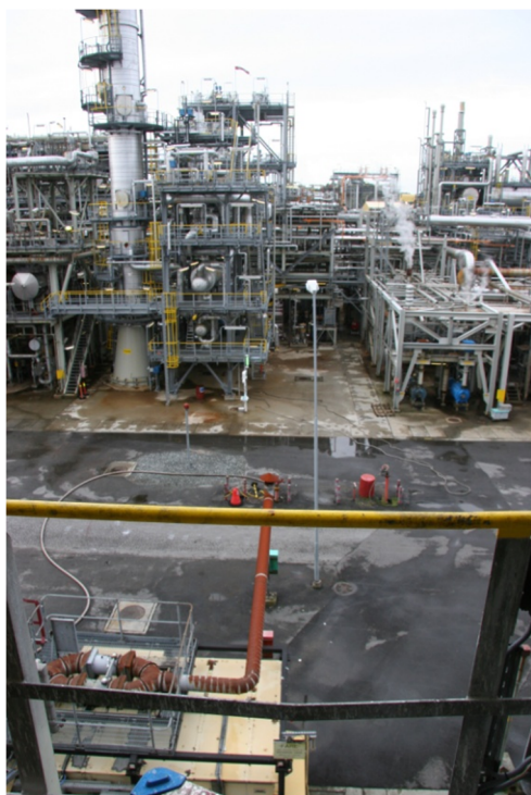
Bilde nr 8. Utsikt fra lekkasjestedet mot anleggene vis a vis
