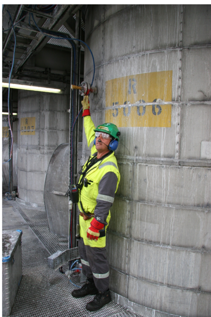
Bilde nr 9. Lekkasjestedet
