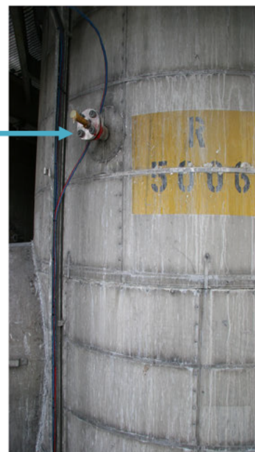
Bilde nr 2. Lekkasjested på R-5006
