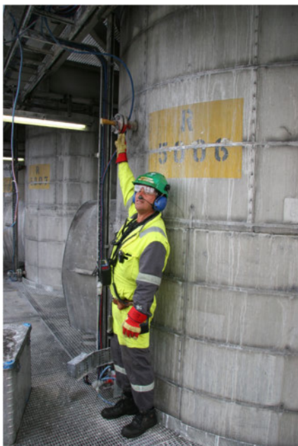
Bilde nr 9. Lekkasjestedet
