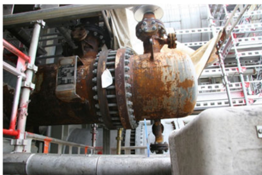
Bilde nr 6a. Varmeveksler E-5002
